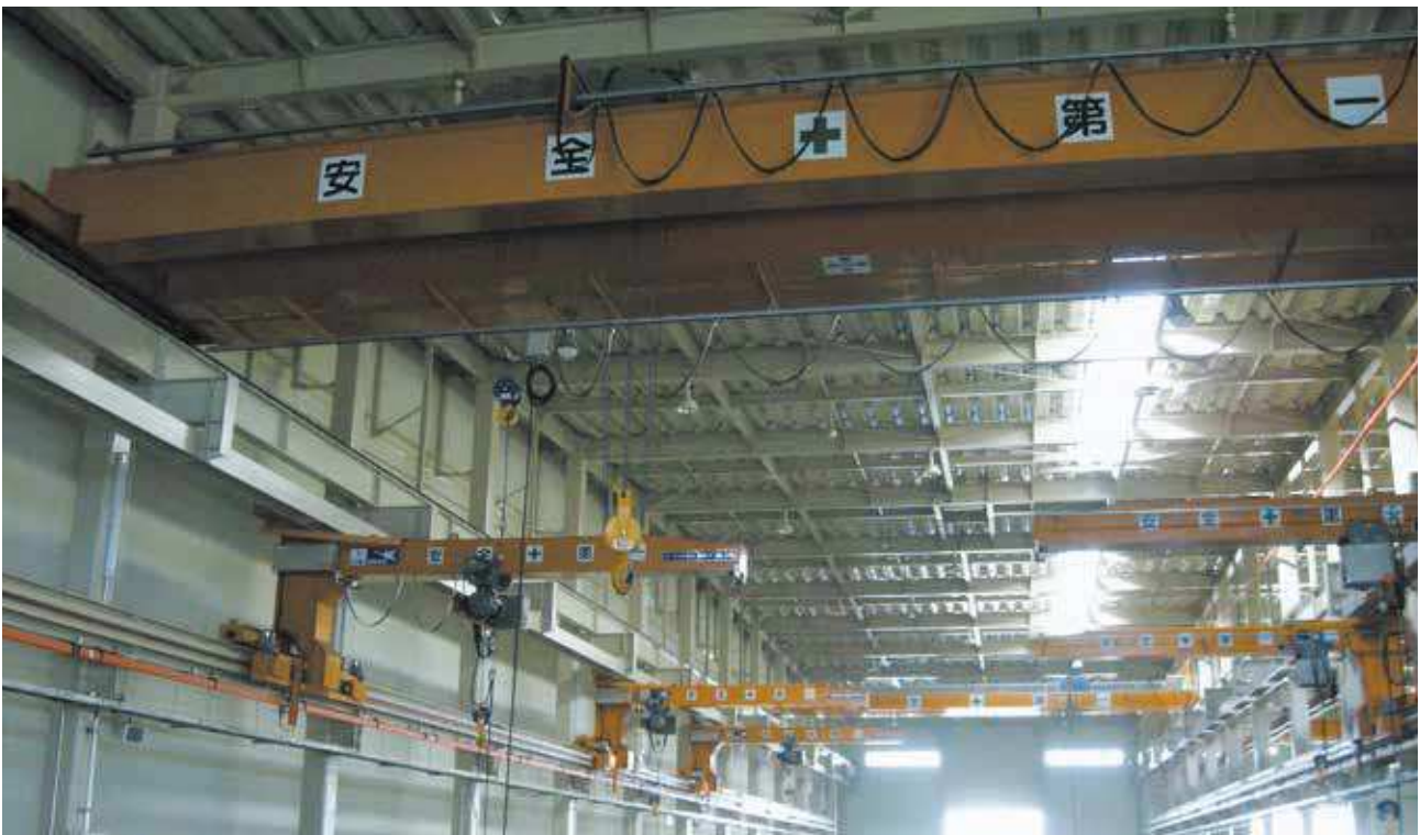
10ton天井走行クレーン 2台 2.8ton天井走行クレーン 7台 ジブクレーン 14台
